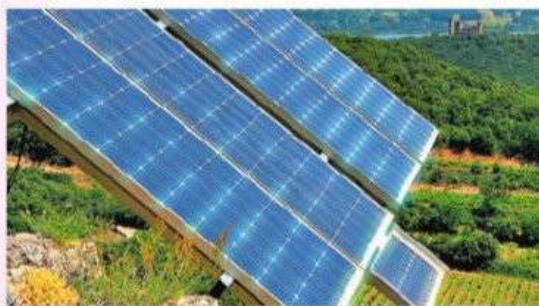
Рис. 202. Панели солнечных батарей
